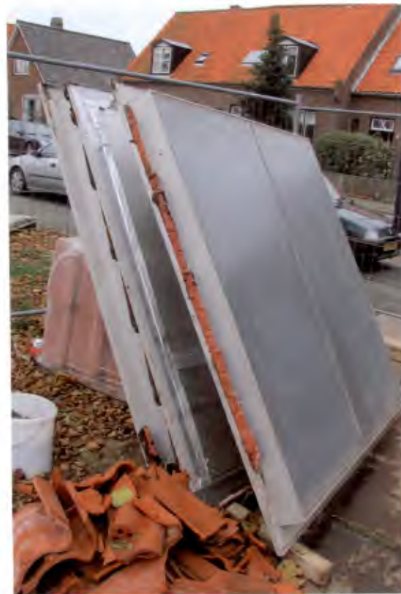
Zonnepanelen die lekkage hebben veroorzaakt, zijn van het dak gehaald. En wat nu?
