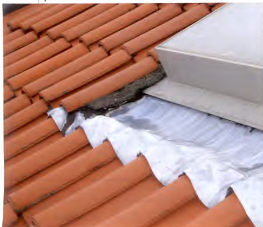
Dit systeem is slecht in het dak afgewerkt. Hier kan je wachten op problemen
